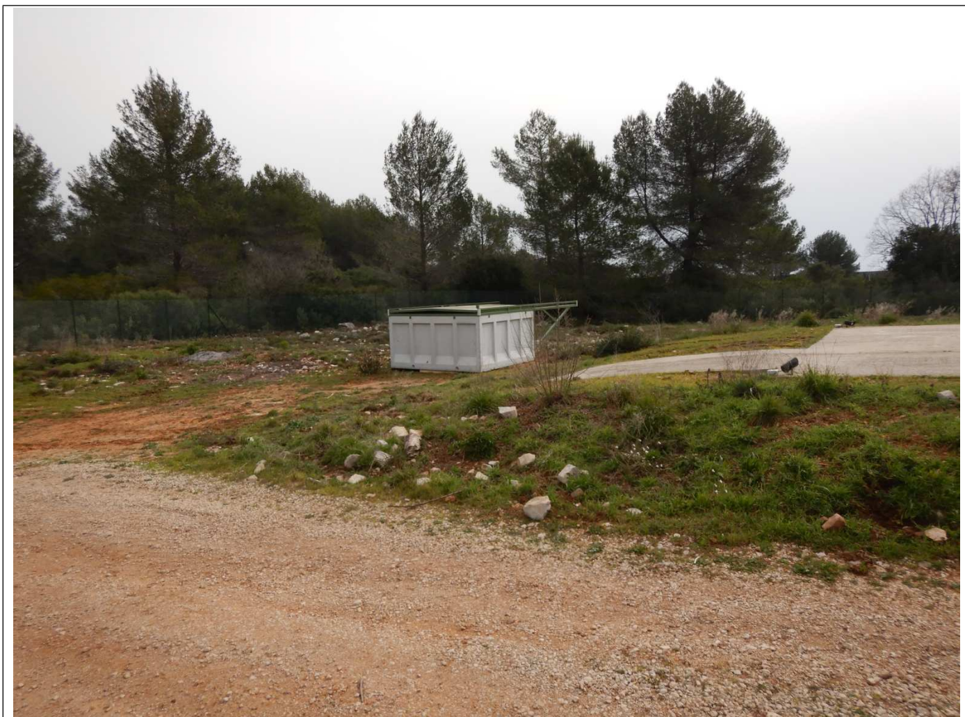
Figure 3 : Photographie d'un bac tampon installé sur la Commune de Valbonne
